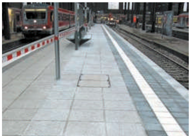
Speziell bei Endlosbauwerken (z. B. Bahnsteige, Rinnen, etc.) ist die Anordnung von Bewegungsfugen erforderlich.
