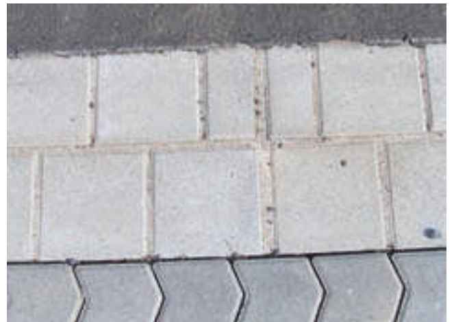
Zugefugte Bewegungsfuge, eine Spannungsableitung ist nicht möglich, dass gesamte Bauwerk kann dadurch Schaden annehmen.
