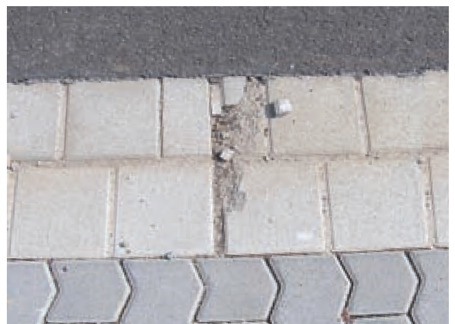
„Ausbrüche an den Pflastersteinen“.
